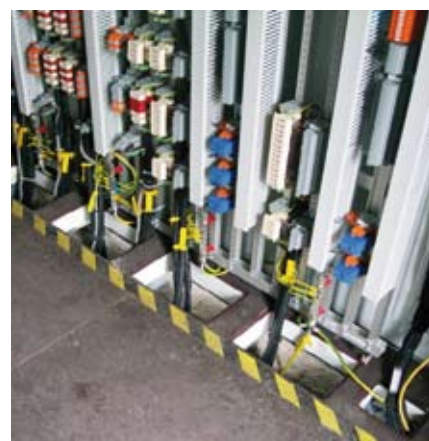
Particolare del passaggio dei cavi dal pavimento
